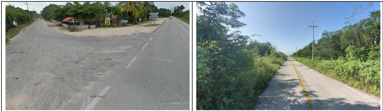
Figuras 6 y 7.- Estado actual de la carretera que conduce al Centro Penitenciario, desde el entronque con la carretera federal 180 y la otra imagen corresponde al mismo camino, a la altura del proyecto ya mencionado.
